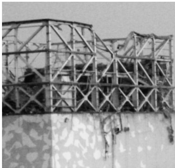
1号機 2012.9.11 写真提供：東京電力株式会社
