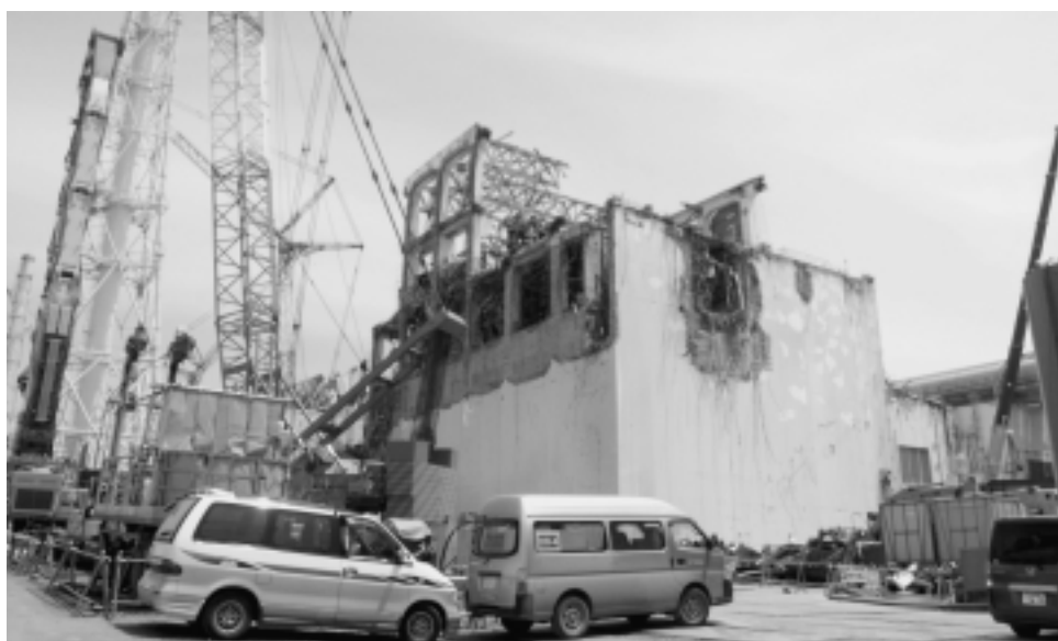
4号機原子力建屋 写真提供：東京電力株式会社
