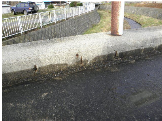
写真-20 地覆の鉄筋露出 (小川代橋)
