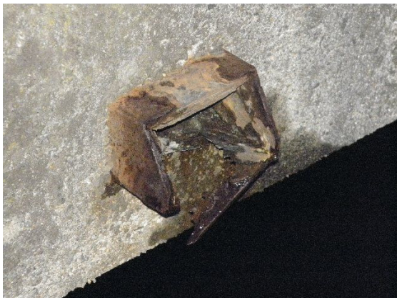
写真-15 排水管の腐食 (新生橋)
