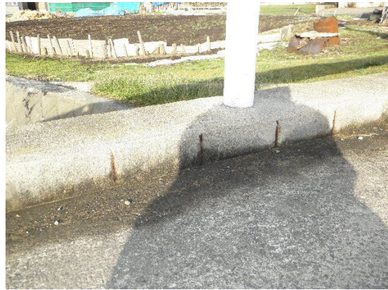
写真-18 地覆の鉄筋露出 (宝来橋)
