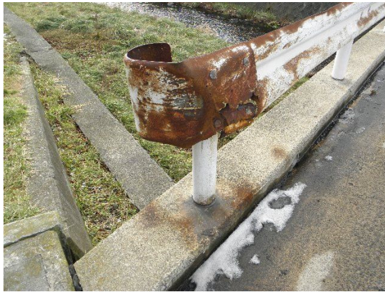
写真-17 防護柵のぐらつき (春日橋)
