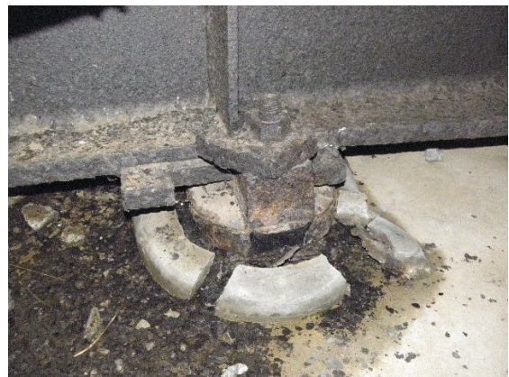
写真2 沓座モルタルの損傷
