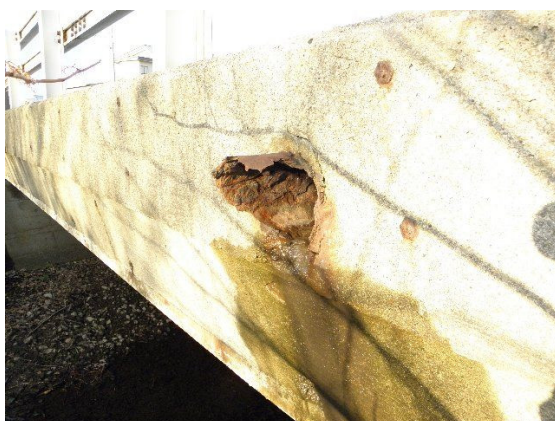
写真-21 排水管の腐食 (小奥戸橋 2)
