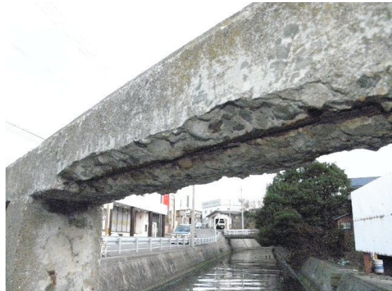
写真-14 防護柵の鉄筋露出 (大間橋)
