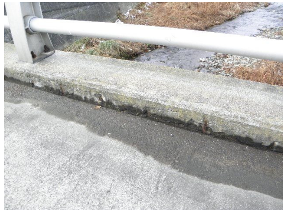
写真-12 地覆の鉄筋露出 (大栄橋)
