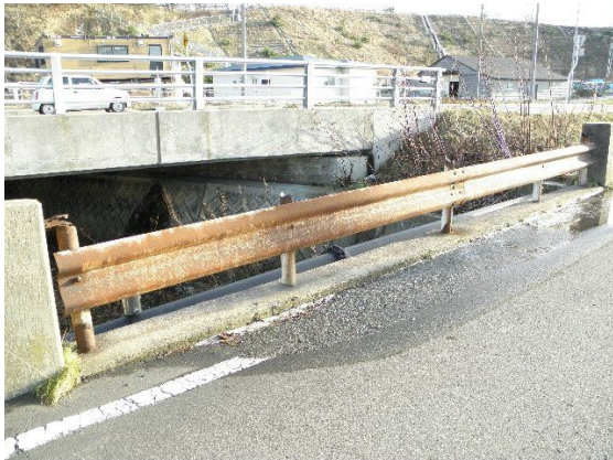
写真-13 防護柵笠木部の欠落 (小奥戸橋 1)
