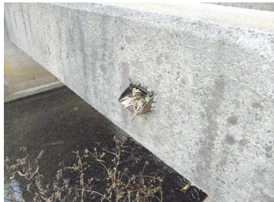
写真-16 排水管の土砂詰り (楓橋)
