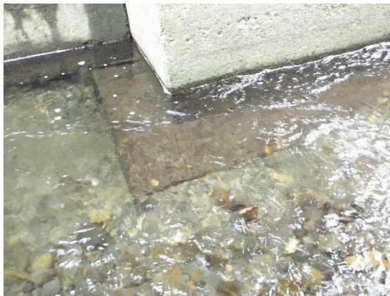
写真-19 基礎の洗掘 (新川目橋)
