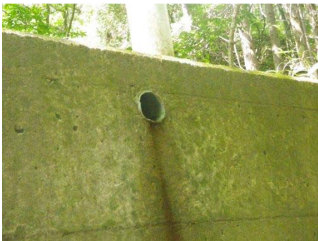
写真11 排水管の損傷
