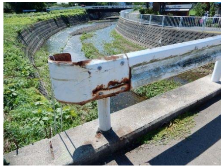
写真10 防護柵の損傷
