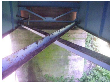
写真2 下横構の損傷
