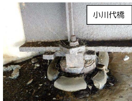
写真1 沓座モルタルの損傷
