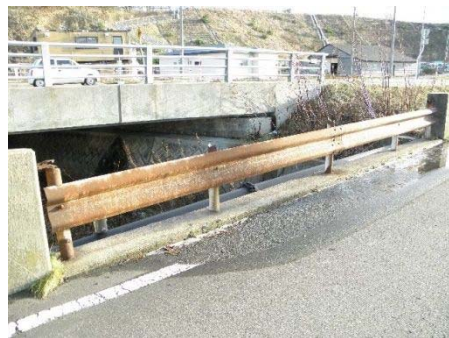
写真4 防護柵の損傷
