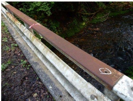
写真3 防護柵の損傷
