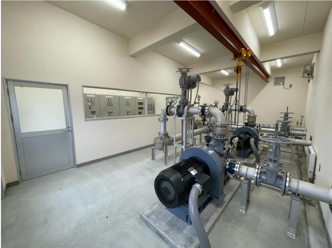
送水ポンプ場ポンプ室(令和5年3月竣工)
